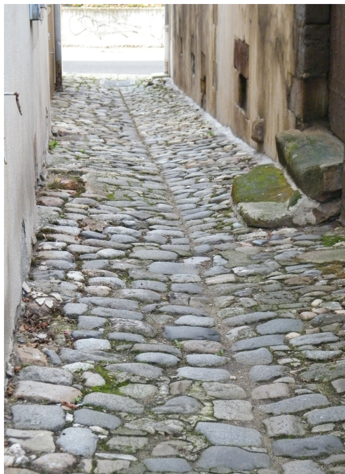
Pavés de la rue Fausse de l'éperon, Moulins
